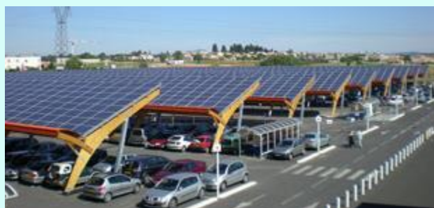
Ombrières de parking équipées de panneaux photovoltaïques
