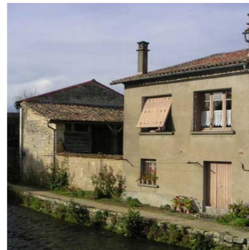
La mauvaise restauration du bâti ancien
